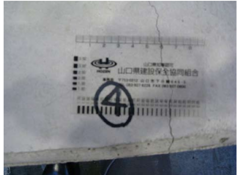
写真6 鋳付き(6cm並列)の 供試体のひび割れ (写真は、0.35mm幅)
