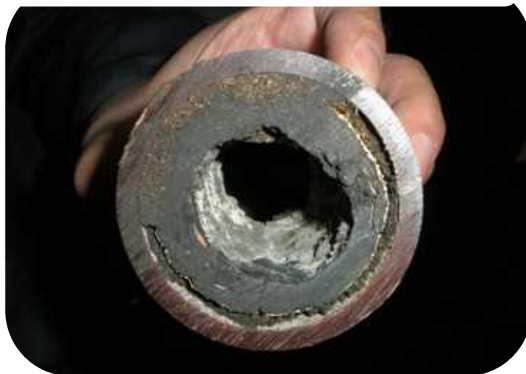
配管のスケール(詰まり)
