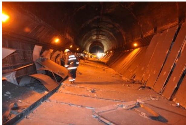
2012年 笹子トンネル 天井板落下事故
