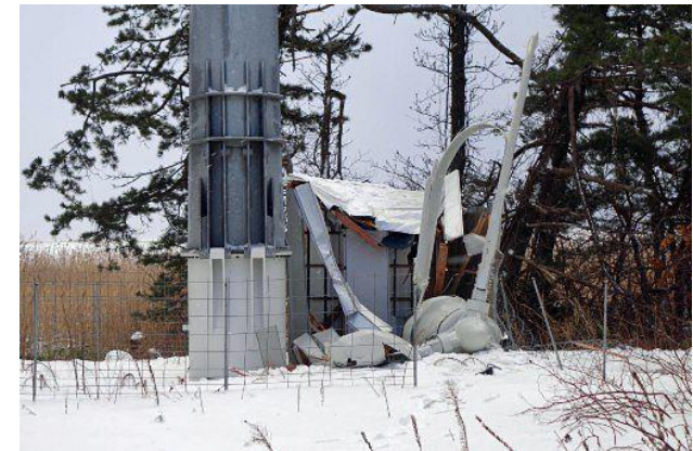
2019年(青森) 小型風力発電設備 ナセル落下事故
