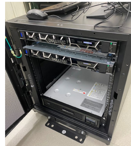
研究室で有している ラックサーバ
