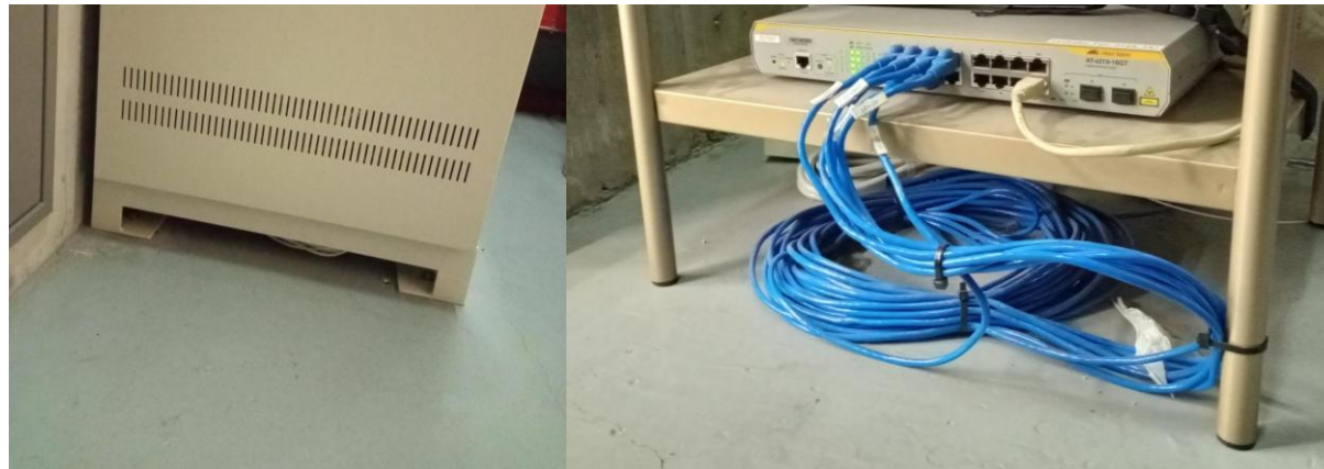
設備の隙間や配線事例
