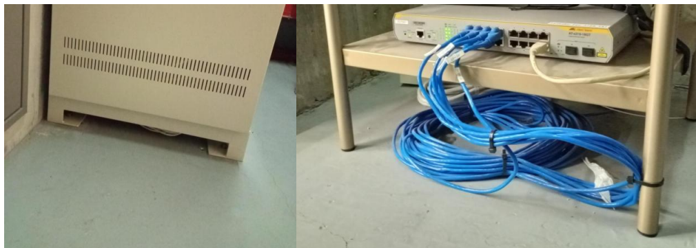
設備の隙間や配線事例
