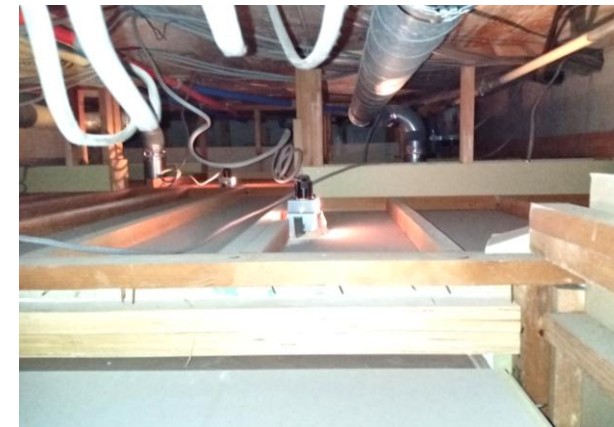
屋根裏の段差事例
